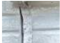
シーリング断裂
